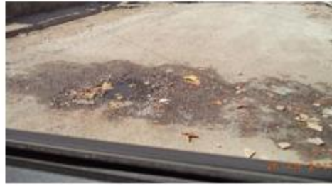
Pavimentação com pontos de acúmulo de água e esgoto.
