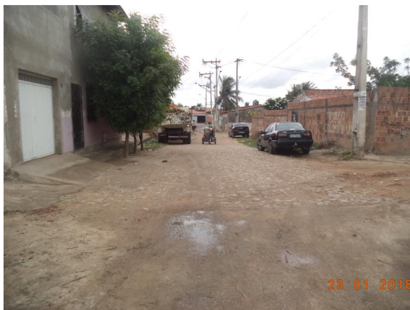
Foto 2 – Ruas com pavimento necessitando de recuperação
