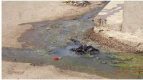
Esgoto a céu aberto na Rua Estudante Ana Kelly
